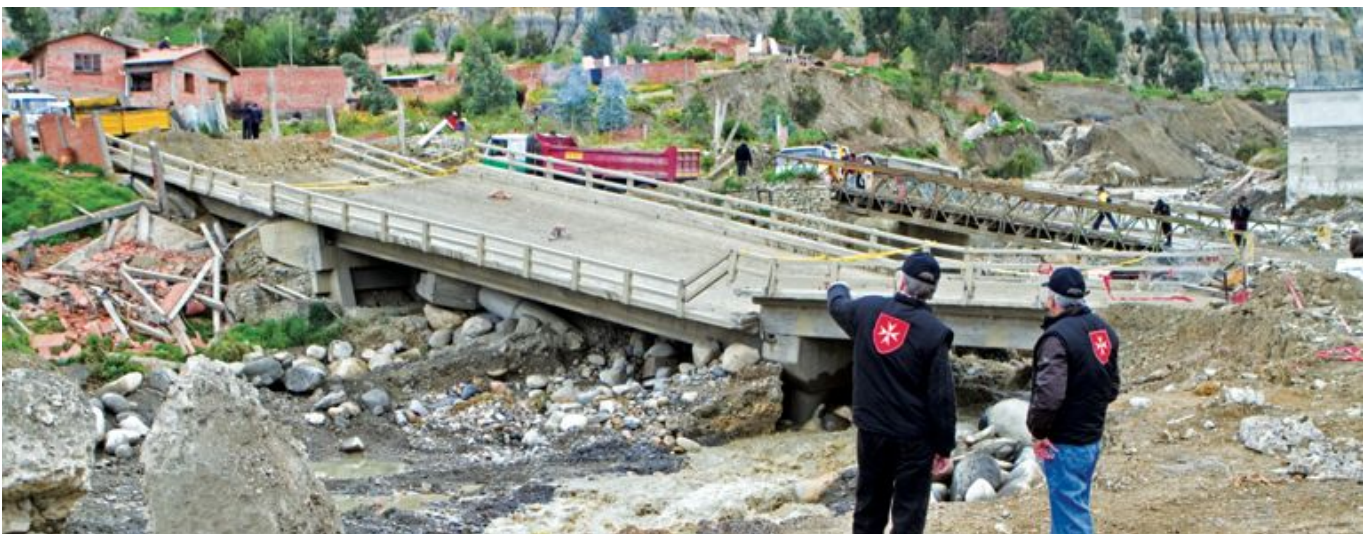
■ Inspeccionando los daños de la inundación en Bolivia
